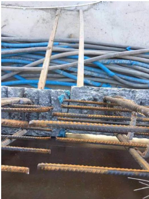
(a) 现浇护壁右侧向外倾斜
